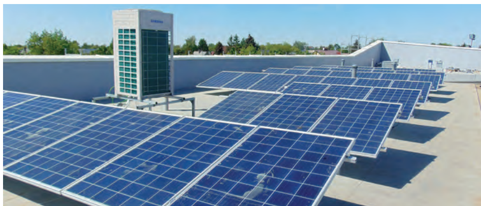
Panele fotowoltaiczne, fot. archiwum budowy
